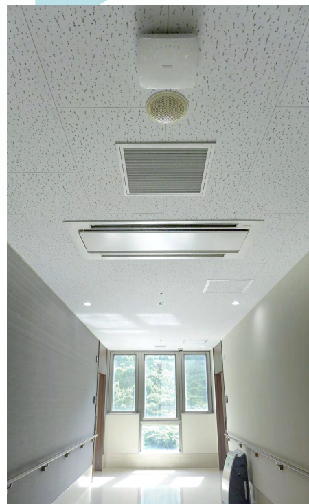
廊下天井部に設置されたAIRRECT AP-6410
