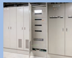
改修後の調光器盤
